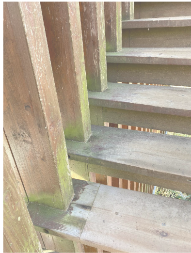
Hongos en el encuentro pilar-escalón
