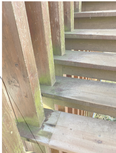
Hongos en el encuentro pilar-escalón
